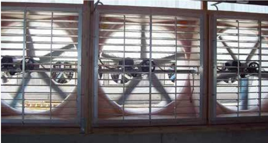
Photo 2 : L'air frais est aussi important dans des bâtisses à ventilation transversale et à ventilation tunnel, comme on peut le voir à la ferme Riverview Dairy près de Morris, au Minnesota.
